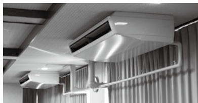
▲改修された空調設備
