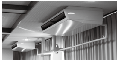
▲改修された空調設備
