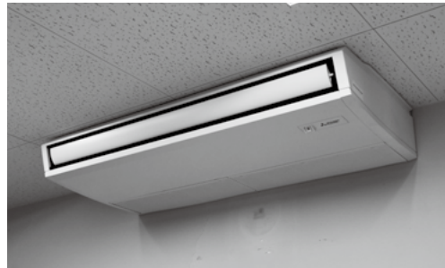
▲改修された空調設備
