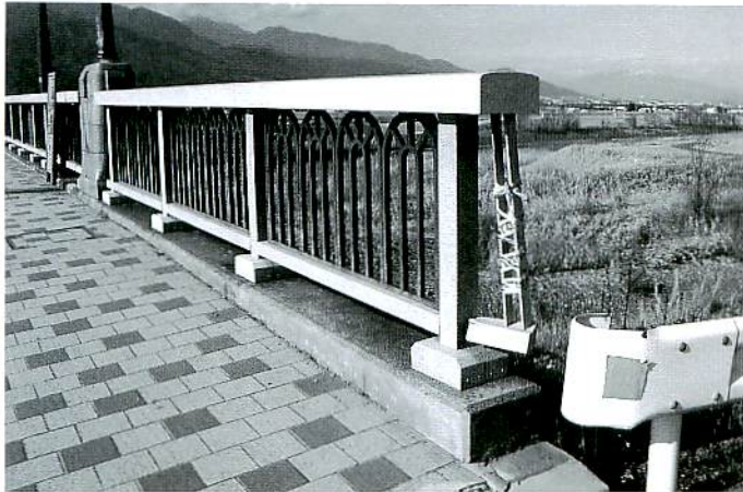
●壊れた富士川大橋欄干
