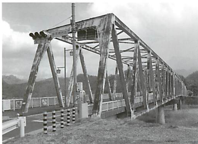
●老朽化著しい峡南橋
