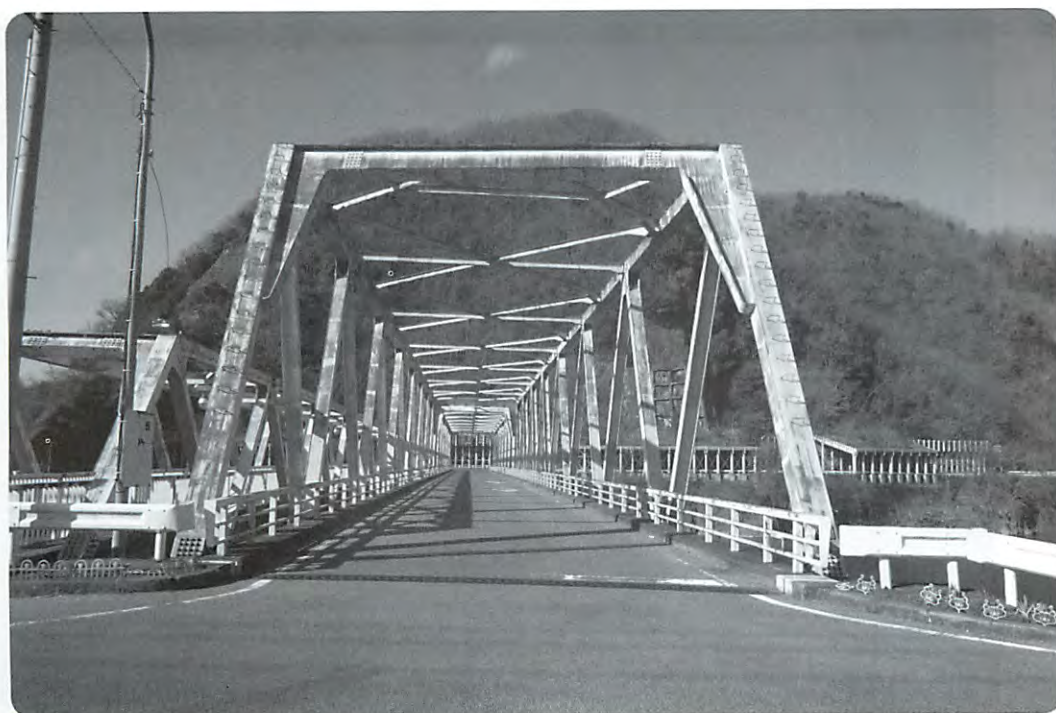
修繕が待たれる月見橋
