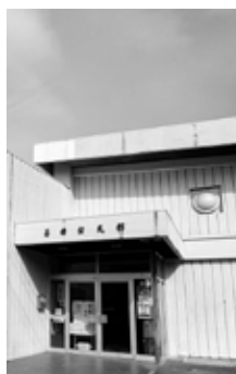
老朽化が進む高田公民館
