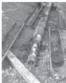
▲パイプ内にこびりついていた固形化温泉成分
