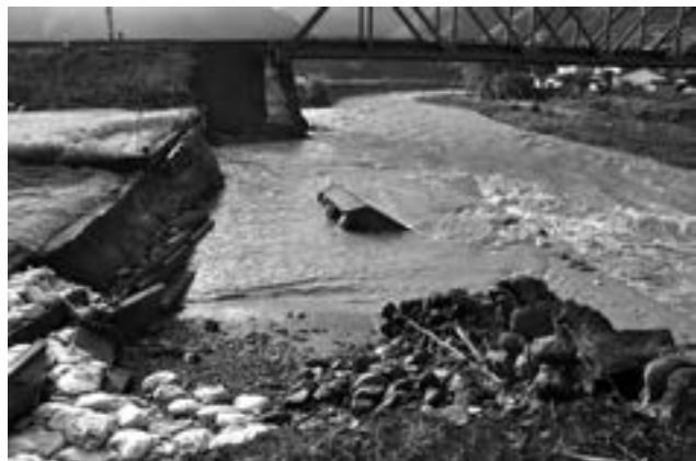
昨年9月21日、台風15号上陸の影響で増水しJR鉄橋右岸が崩壊した芦川
