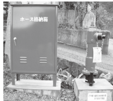
▲整備された消火栓
