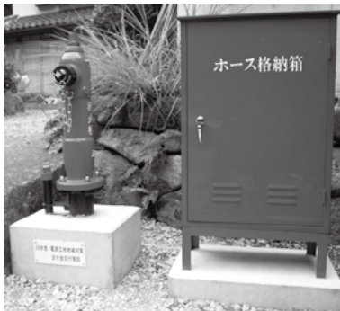
▲整備された消火栓とホース格納箱
