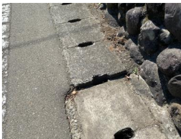
側溝がたがたする。隙間・段差がある。
