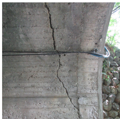
コンクリート覆工にひびわれ・豆板が目立つ(H30)
