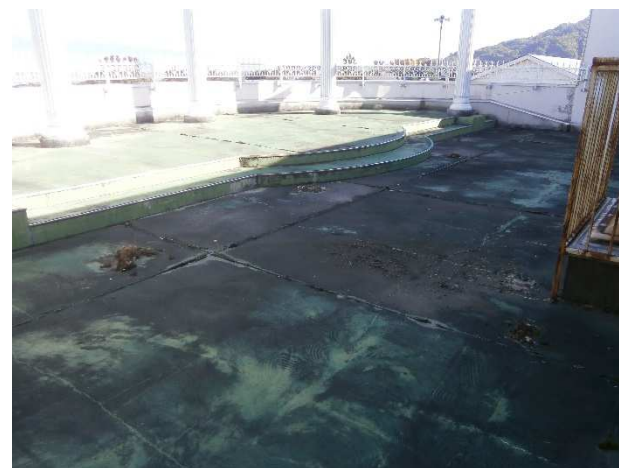
屋根防水シート破損状況
