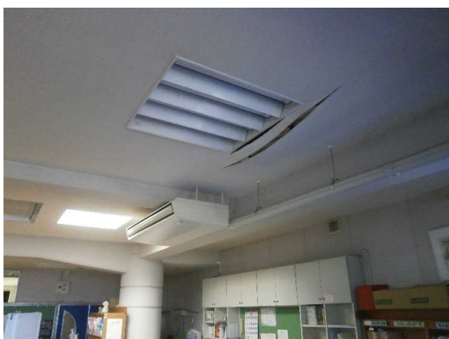
雨漏り影響による天井垂れ
